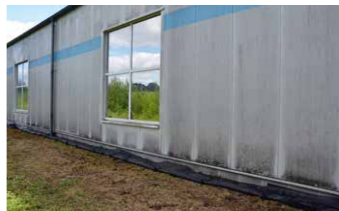
An dieser Industriefassade haben sich bereits unschöne organische Verschmutzungen abgesetzt. Zeit für wir-reinigen-fassaden.
